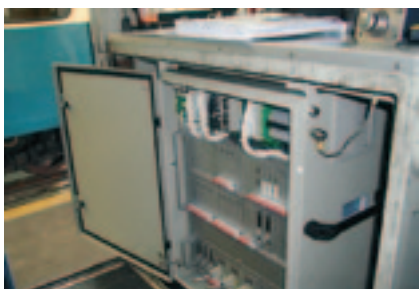
Рис. 6. Шкаф с аппаратурой устройства LZW M21
