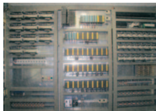
Рис. 4. Постовое оборудование МПЦ Sicac S7
