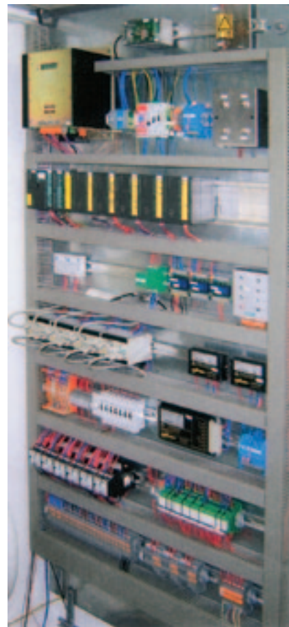
Рис. 5. Аппаратура системы переездной сигнализации BUE S7 в бетонном киоске
