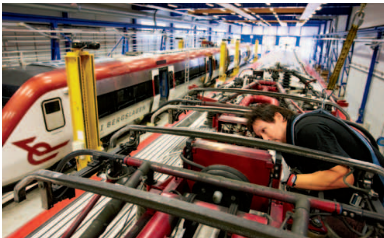
Депо компании Bombardier в Гётеборге для фирменного технического обслуживания электропоездов Regina (фото: Bombardier)
