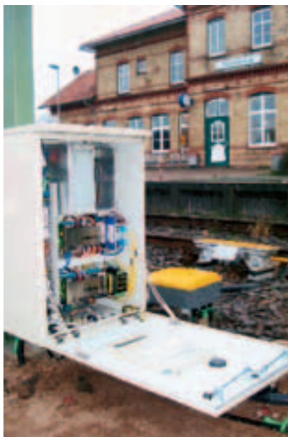
Рис. 4. Управляющий модуль ввода-вывода
